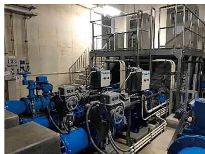
柿崎川ダムのマイクロ水力発電
